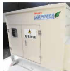
LPガス非常用発電機
