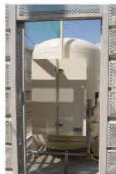
LPガスを貯蔵するタンク（災害対応型パレクタンク）
